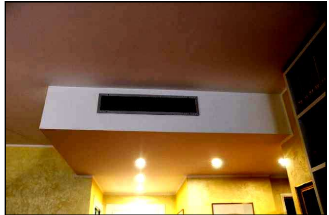
26.- Controsoffitto soggiorno con bocchetta A.C.
